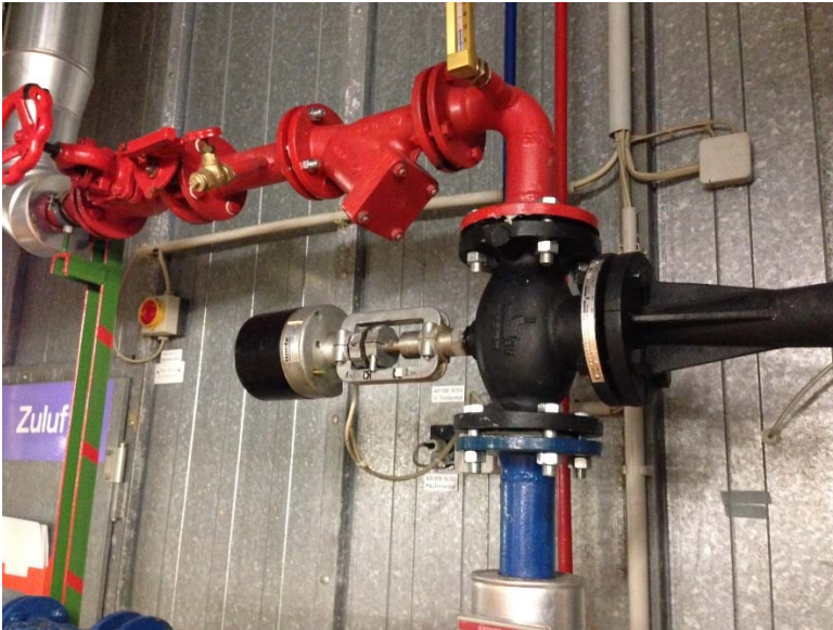
Figure 2 Éjecteur installé en 1977 dans un bâtiment de la Freie Universität de Berlin
