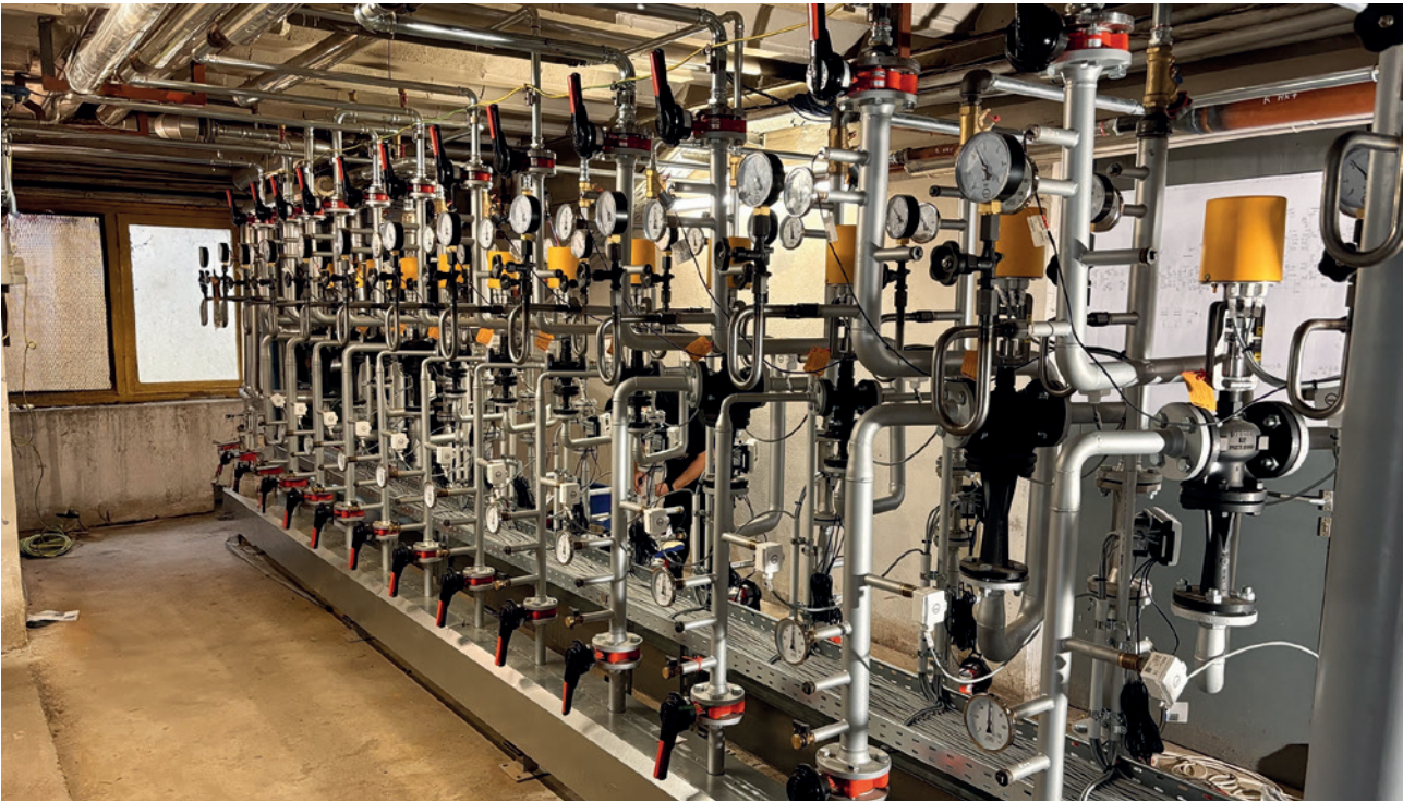
Heizungsverteiler Hydripilot mit Strahlpumpenaufbaugruppen
