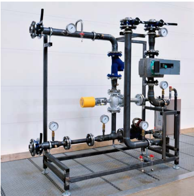
Figure 3 Sous-station de chauffage urbain prémontée avec éjecteur
