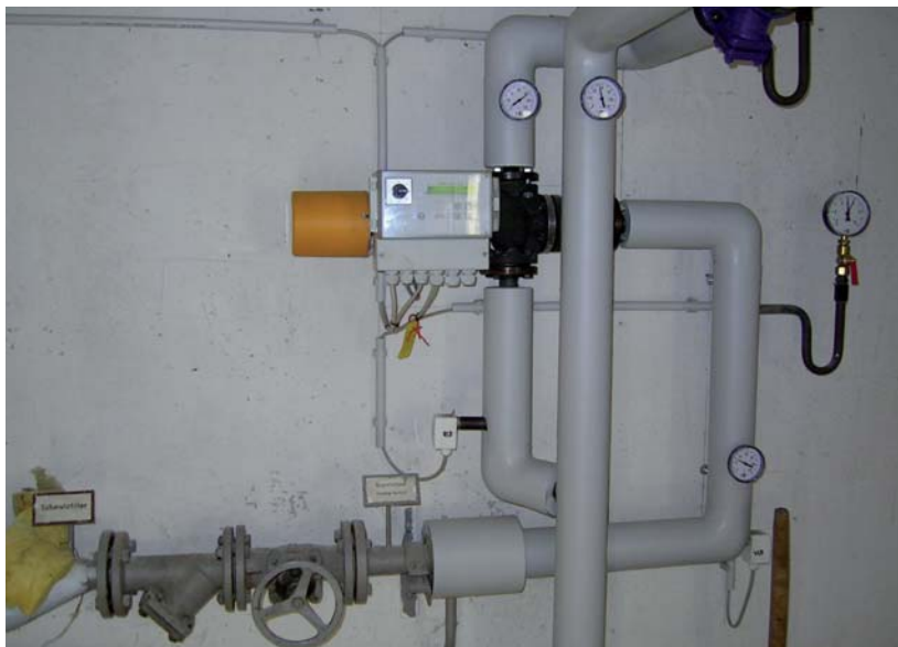
Bild 7: Strahlpumpe mit Regler in einer Nahwärmestation.
