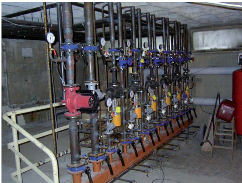
Bild 8: Heizungsverteiler mit Strahlpumpen und einer Hauptpumpe.
