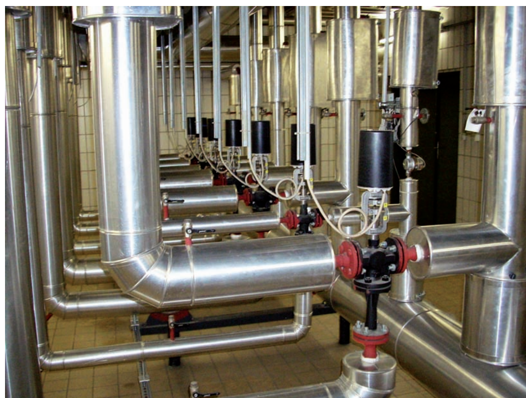
Bild 7: Moderne Wärmeverteilung mit Strahlpumpen.
