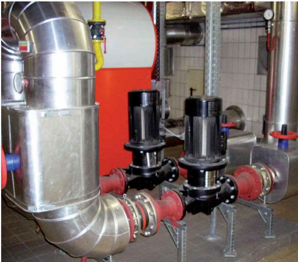
Bild 3: Drehzahlgeregeltes Doppelpumpenaggregat für die Energieversorgung.
